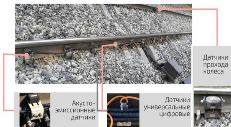
Рис. Расположение датчиков на железнодорожном пути комплекса ПАУК-11к
